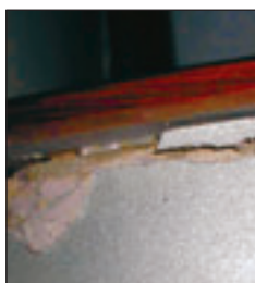
poškození staveb vlhkostí
